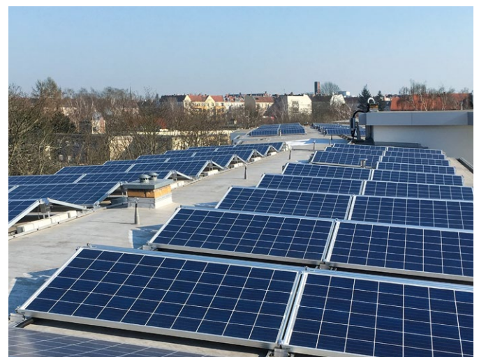
Abb. 11 | Mieterstrom-Anlage in Wilmersdorf, Kenndaten auf S. 26 /Berliner Energieagentur/
