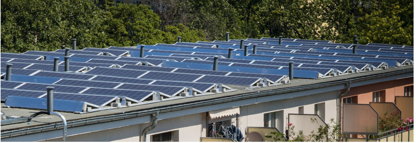
Abb. 7 | Mieterstrom-Anlage in der Fuldastraße und Ossastraße, Kenndaten auf S. 26 /BürgerEnergie Berlin/
