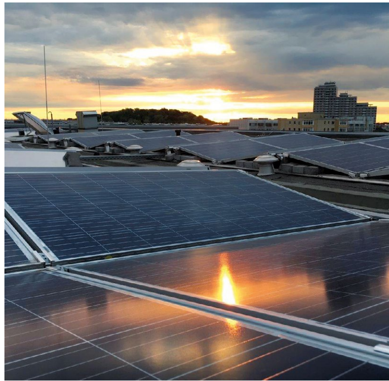
Abb. 14 | Mieterstrom-Anlage auf vier Dächern denkmalgeschützter Plattenbauten in der Mollstr., Kenndaten S. 27 / Berliner Stadtwerke/
