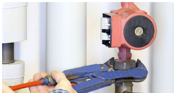
Abb. 37 | Tausch einer Heizungspumpe /23/
