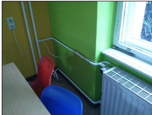
Abbildung B 6: Caterer A: ungesicherte elektrische Leitung
