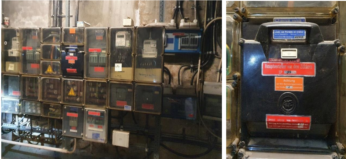
Abbildung 11: Hausanschlussstation im LPG-Gebäude für Strom für das Gebiet der Phase I (links); Hauptstromverteiler der Hausanschlussstation (rechts) 27
