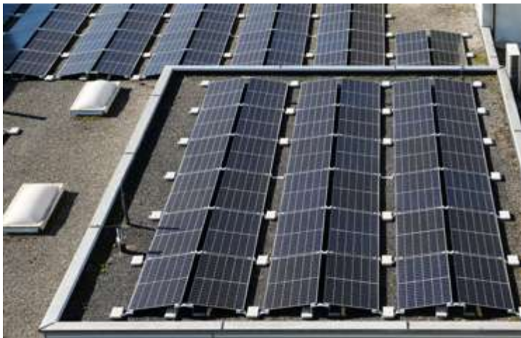
Abbildung 23 PV-Anlage auf Flachdach.
