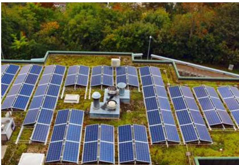
Abbildung 28 PV-Anlage auf einem Gründach.
