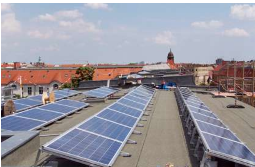
Abbildung 1 PV-Anlage auf denkmalgeschützten Objekten der Wohnungsbaugenossenschaft „Bremer Höhe“.
