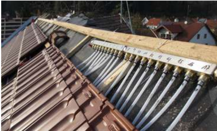
Abbildung 27 In Dachziegel integrierte Solarthermieanlage.
