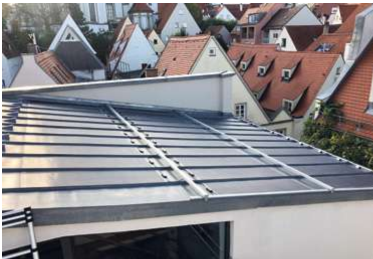
Abbildung 57 Leichte, aufgeklebte Module auf einem Metaldach.
