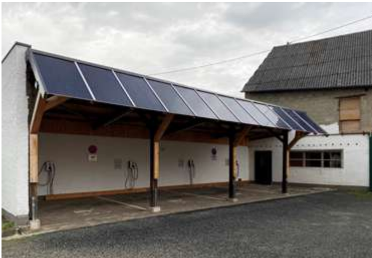
Abbildung 53 PV-Anlage auf einem Vordach.
