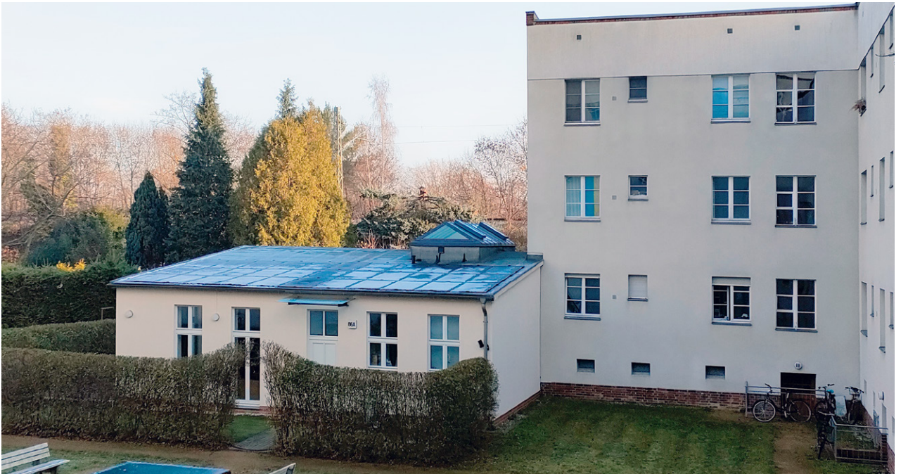
Abb. 12: Das Dach eines denkmalgeschützten Nebengebäudes ist aus dem halböffentlichen Raum einsehbar. Die Sichtbarkeit konnte durch eine PV-Anlage mit flachen Modulen reduziert werden
