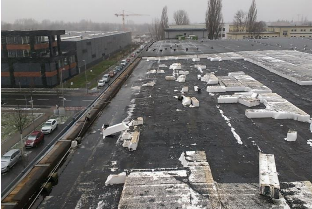
Nach Sturm im Dez. 2013 bereichsweise abgedecktes Dach
