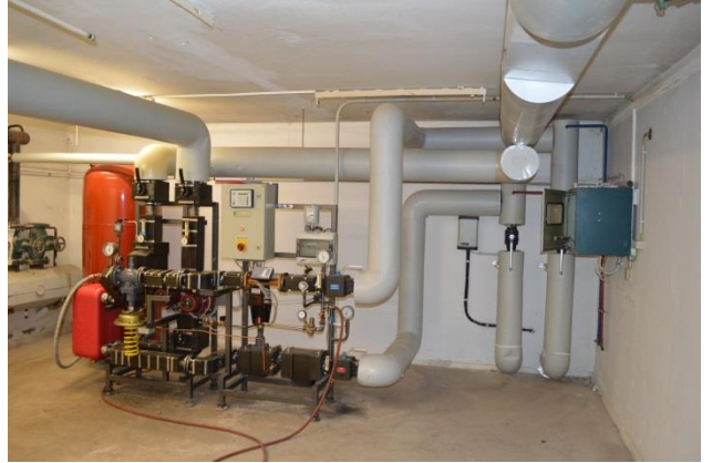
Fernwärmestation im Keller
