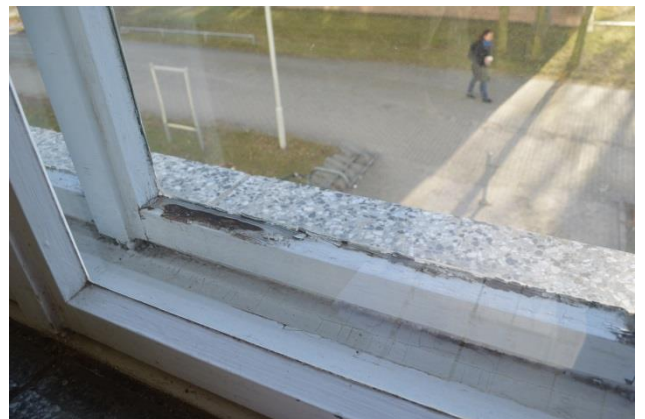
Unsanierete Kastenfenster im EG der Süd-Ost-Fassade Nach Sturm im Dez. 2013 bereichsweise abgedecktes Dach
