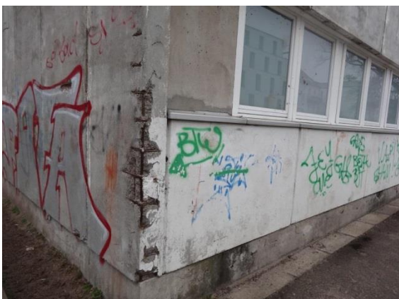
Schaden an der Aussenwand
