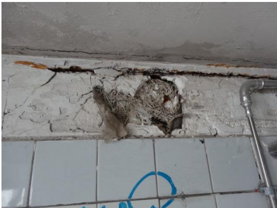
Innenseitiger Schaden an der Außenwand
