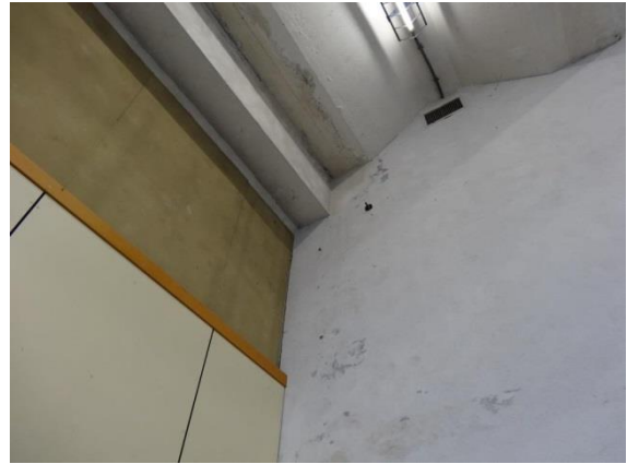
Wasserschaden an der Decke (Dachabdichtung aber zwischenzeitlich saniert)
