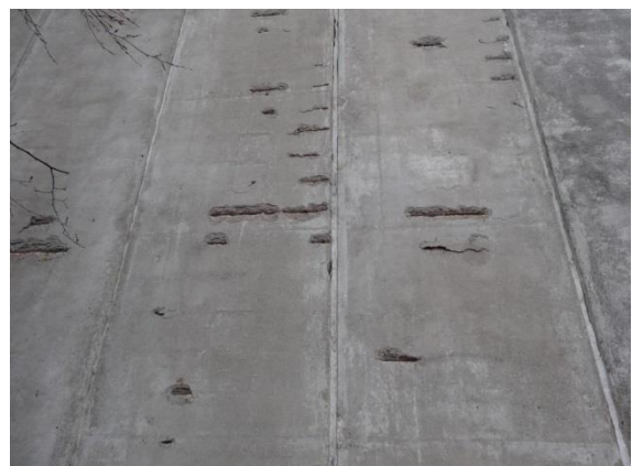
Zustand der unsanierten Fassade
