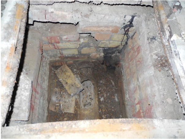
Zustand der alten Abwasserleitung
