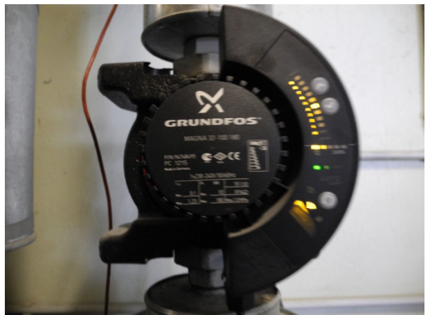
Grundfos Umwälzpumpe der Heizungsanlage
