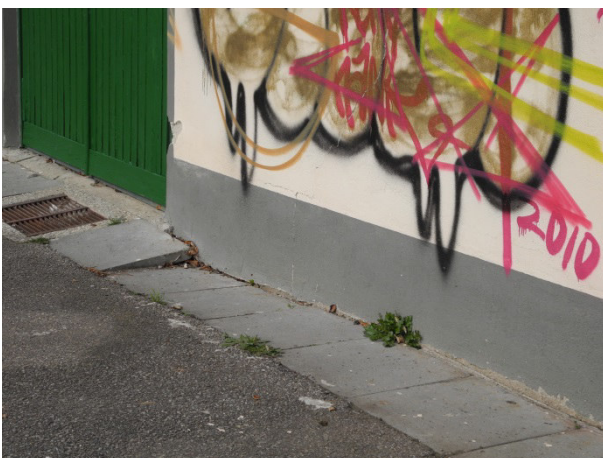
Riss in der Fassade wegen abgesenktem Boden
