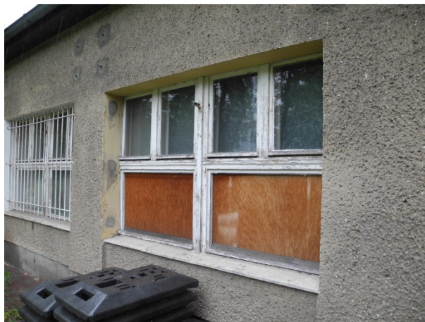
Zustand der alten Holzfenster
