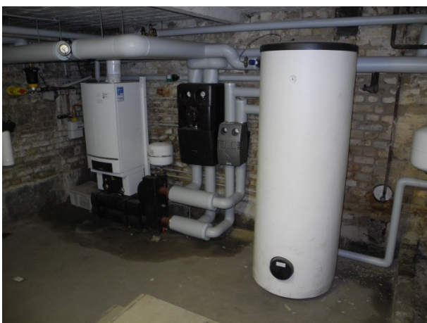
Heizungsanlage im unbeheizten Keller
