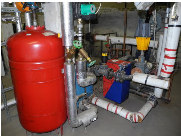
Fernwärmestation im Untergeschoss der Halle
