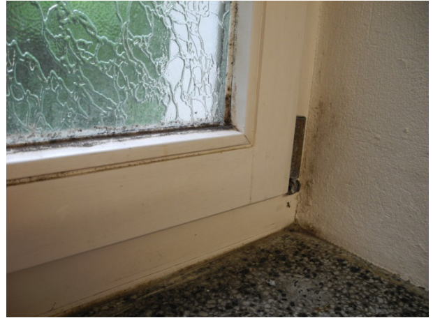
Schimmelpilz an Fensterrahmen in einem Sanitärraum
