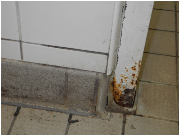
Zustand Stahlträger in einem Sanitärraum
