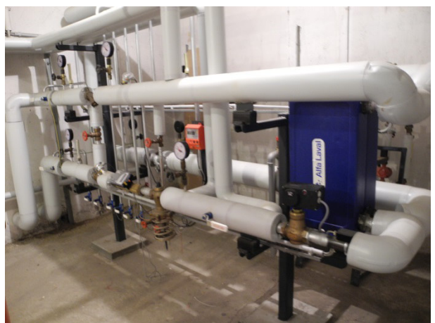
Fernwärmestation im Untergeschoss
