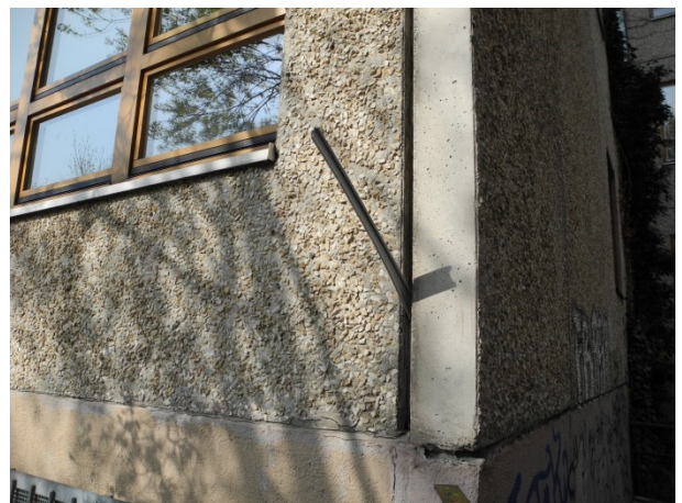
Schadhafte Dichtungen Betonplattenfugen
