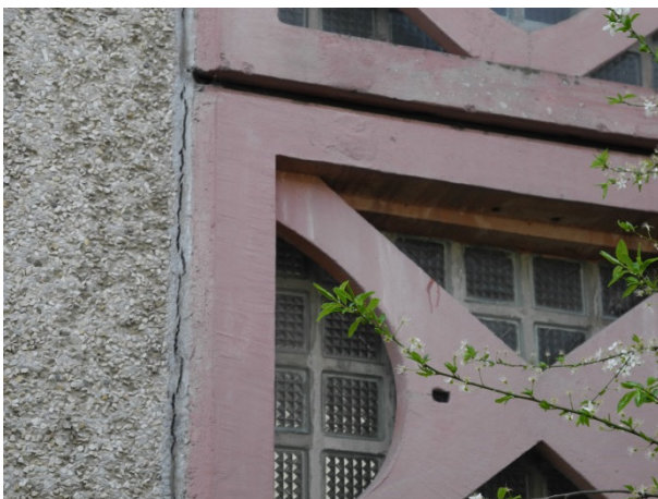
Risse neben Treppenhausfenstern Nord-Ost-Seite
