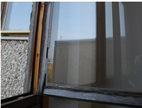
Beispiel Fehlender Fensterkitt
