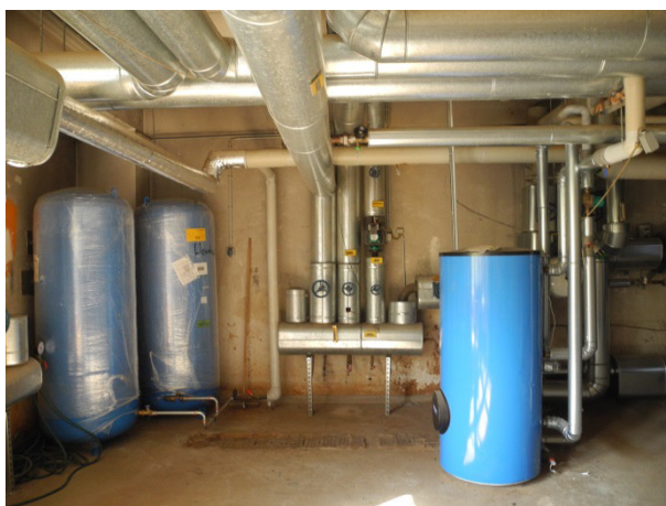
Warmwasserspeicher und Druckausdehnungsgefäße
