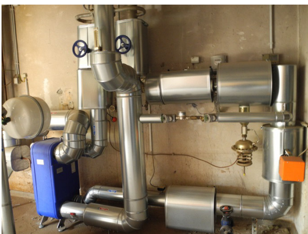
Fernwärmestation im Heizungskeller
