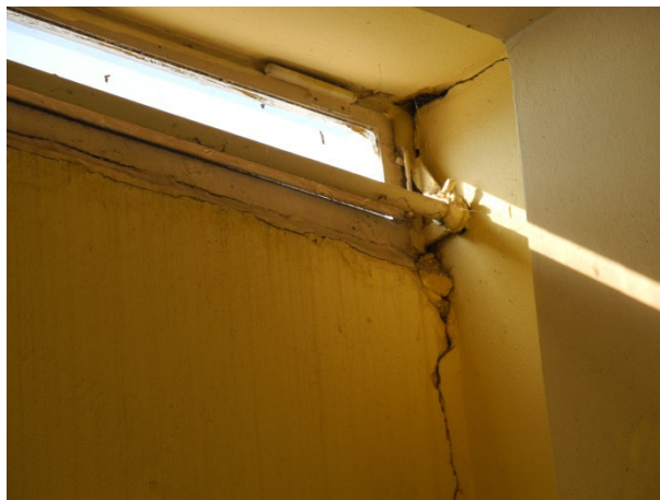
Nicht dichtschießende Treppenhausfenster
