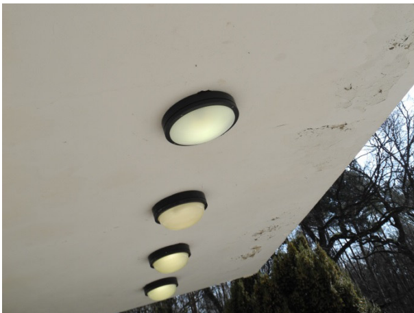
Außenbeleuchtung am Tag in Betrieb, Vordach undicht
