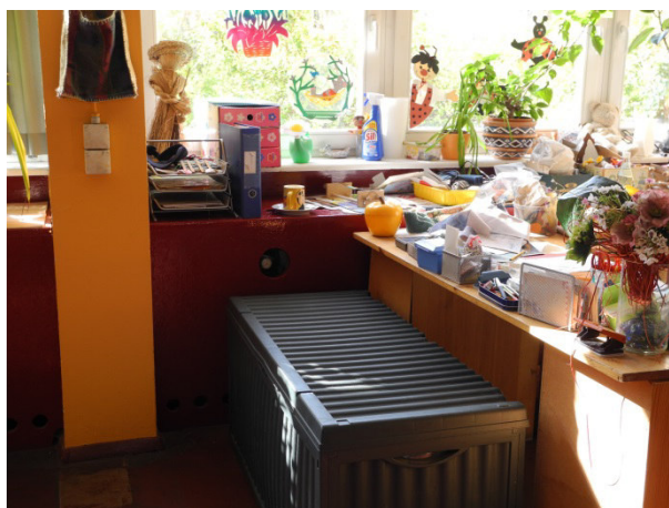
Beispiel umbauter und zugestellter Heizkörper im Keller
