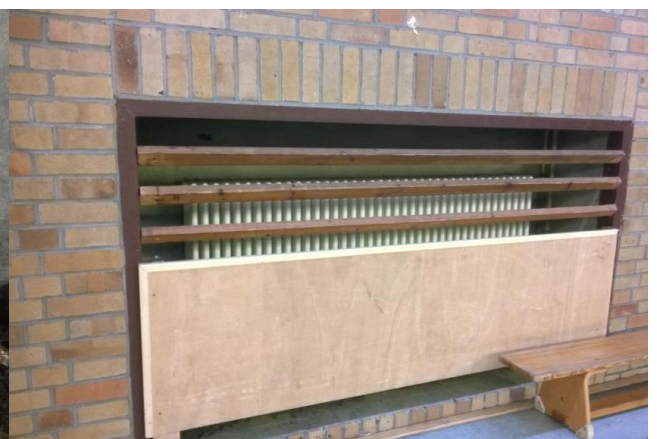
Heizkörper in der Sporthalle hinter Verkleidung
