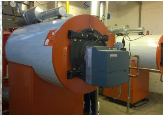
Heizungsanlage im Hauptgebäude (Grundschule am Berg)
