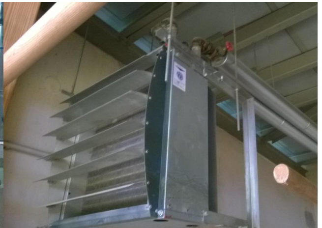
Umluftheizgerät in der Sporthalle
