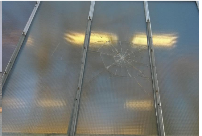
Beschädigtes Fenster auf der Nord-Ost-Seite
