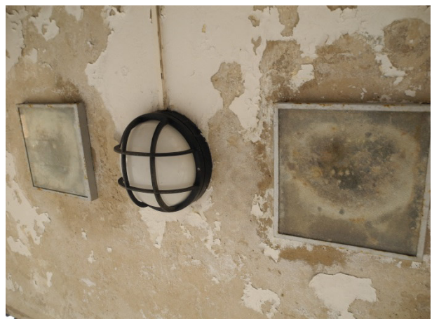
Außenbeleuchtung Vordach Eingang Ausbildungszentren
