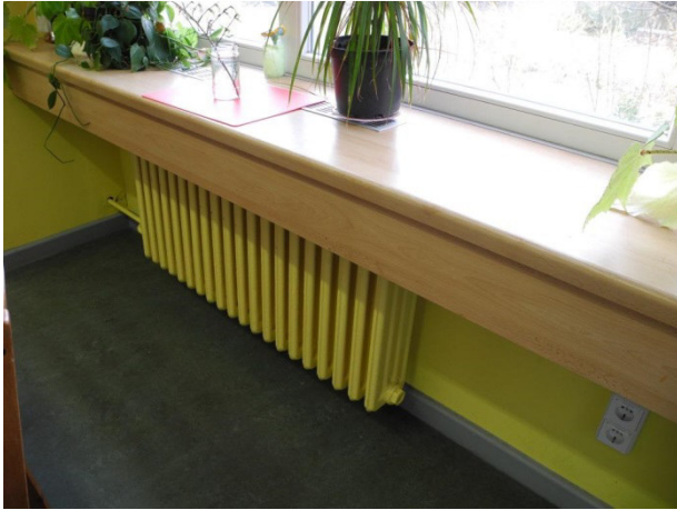
Heizkörper unter Abdeckung in Küche
