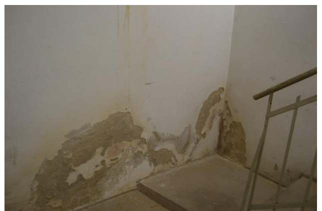
Feuchteschäden an erdberührenden Kellerwänden
