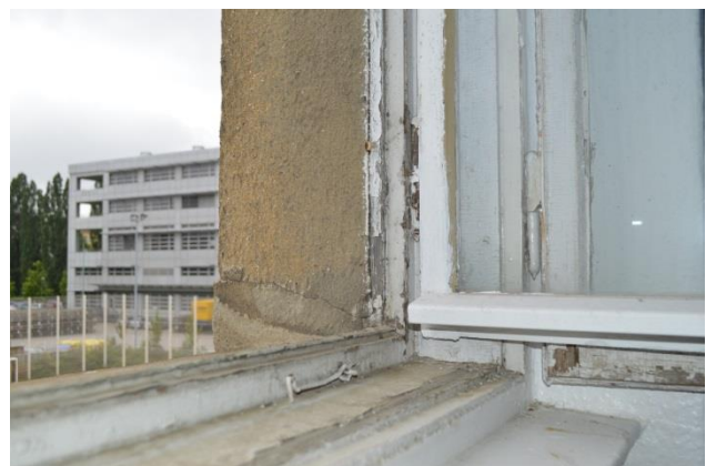
Beispiel zum Zustand der Kastenfenster
