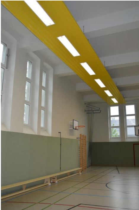
Deckenstrahlplatten in Turnhalle
