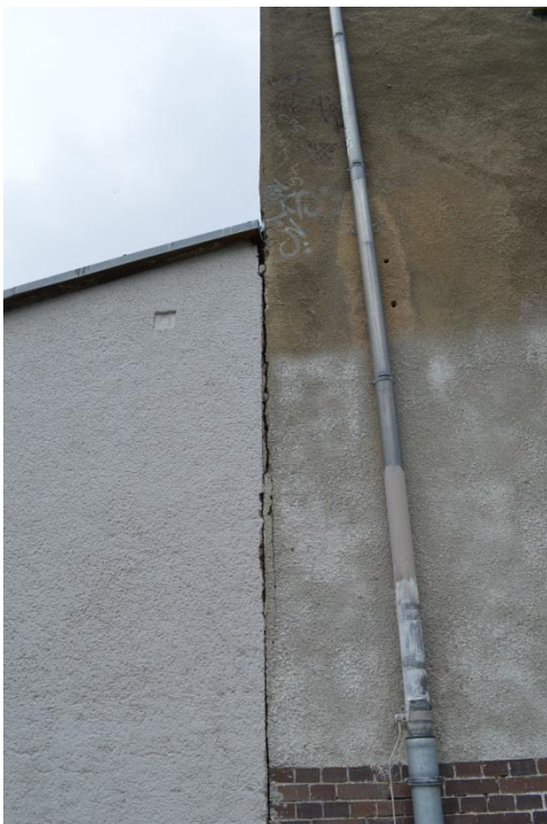
Spalt zwischen Turnhalle und Anbau
