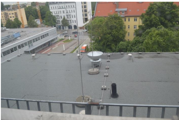
Abluftpilz über WC-Trakt
