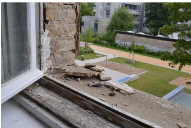
Beispiel zum Zustand der Kastenfenster
