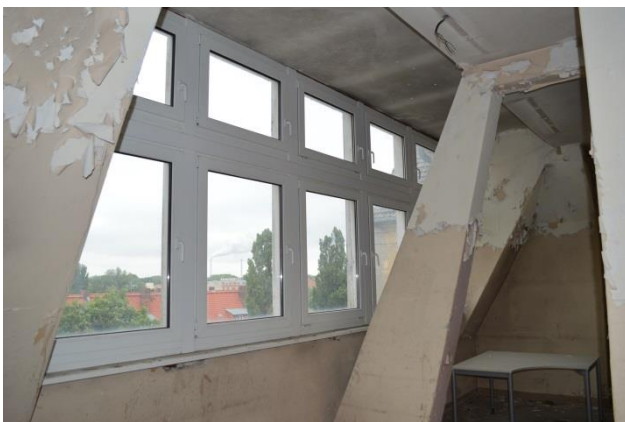
Fenster im ungenutzten Dachboden (vermutl. Einbaujahr 98)
