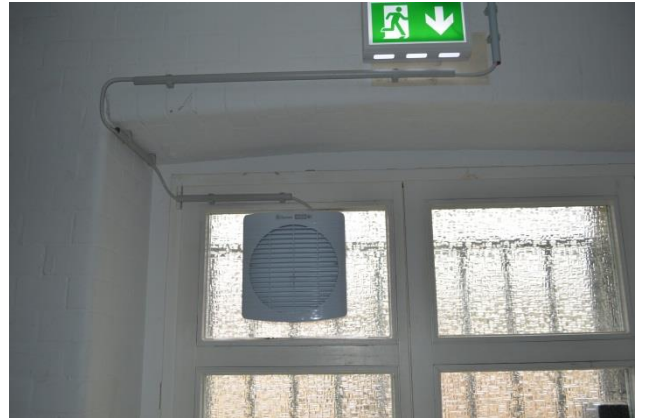
Abluftventilator in Umkleieraum
