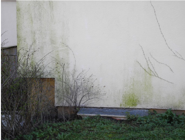
Algenbewuchs an WDVS Fassade
