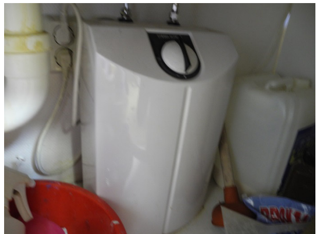
Elektrisch beheizter Kleinspeicher, Hausmeisterbüro
