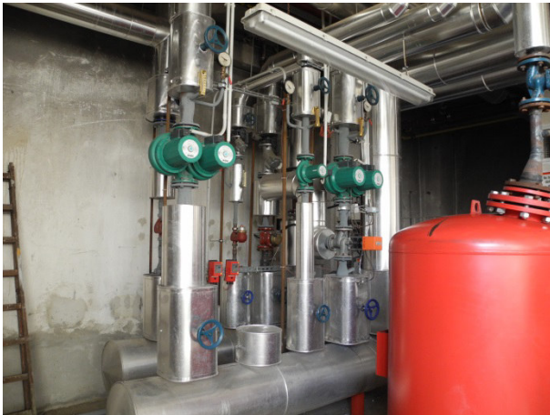
Verteilerstation der Heizungsanlage
