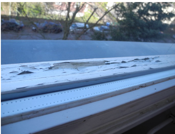
Beispiel Zustand Fenster Nord-West Seite
