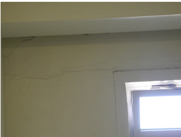
Risse im Innenputz
