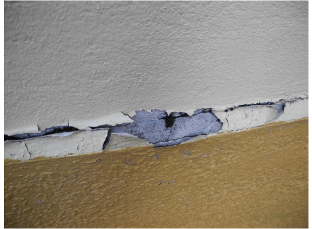
Beispiel Farbabplatzungen Fassade
