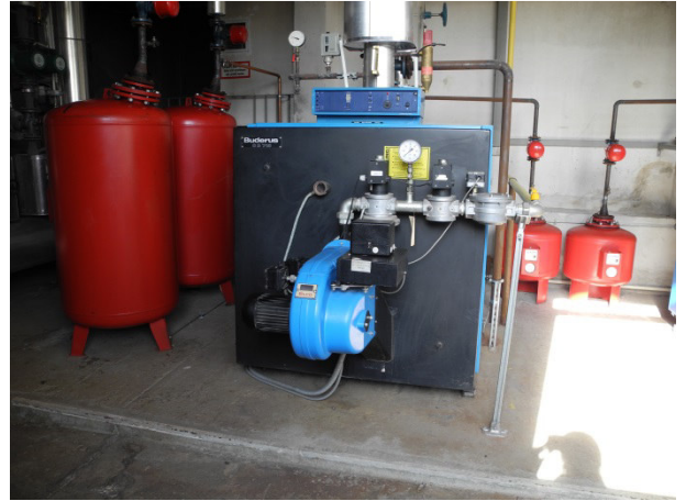
Brennwertkessel mit Druckausgleichsbehältern
