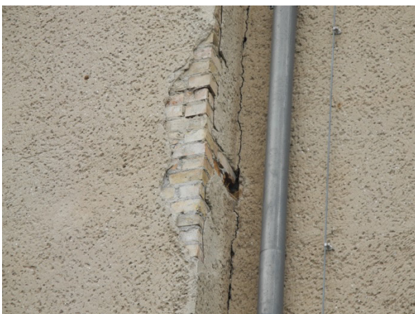
Beispiel Schaden an der Fassade
