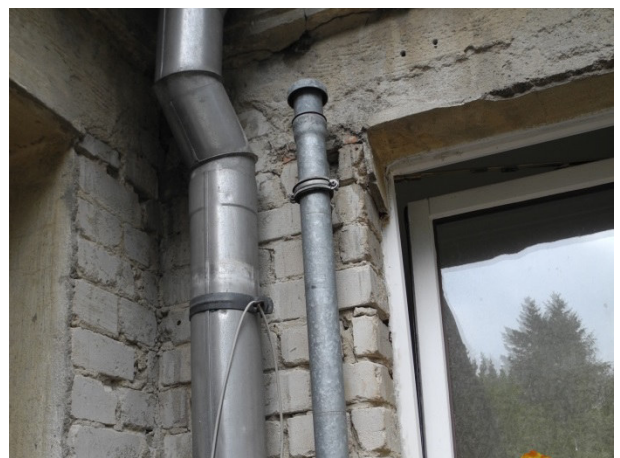
Schaden an der Süd-Fassade (Sanitarräume)
