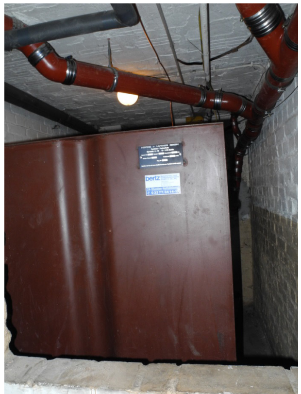
Heizöltank im Keller unterhalb der Aufenthaltsräume
