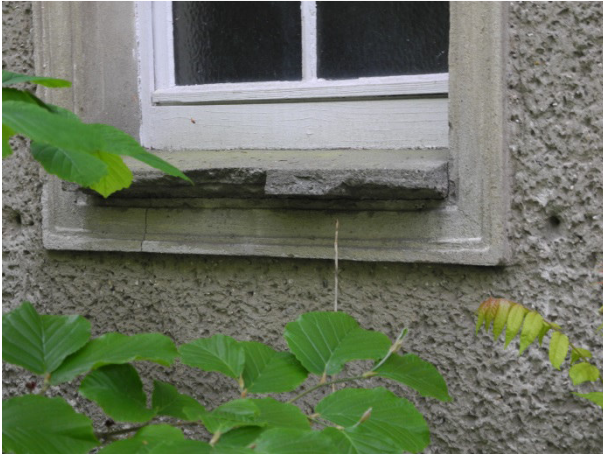
Schaden an einer Fensterbank (Ost-Fassade Feierhalle)
