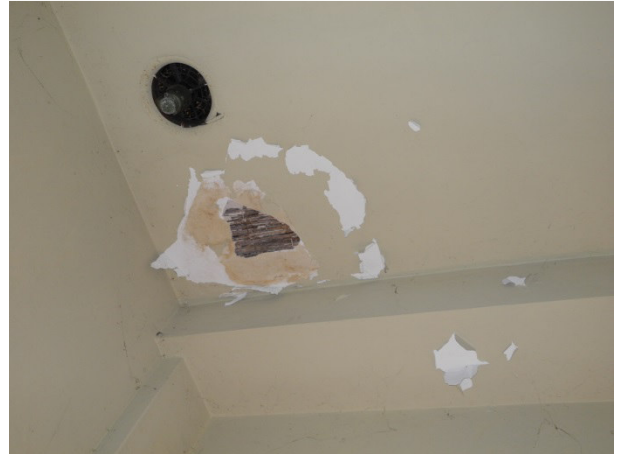
Schaden Decke Lagerraum Feierhalle
