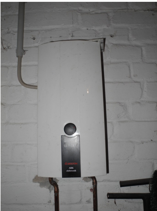
Elektrisch beheizter Durchlauferhitzer
