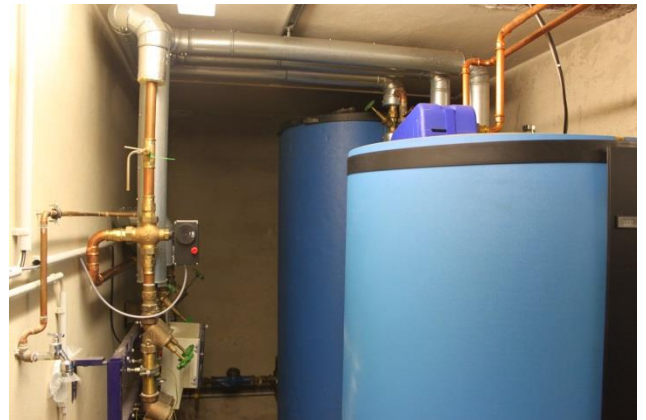
Warmwasserspeicher - Buderus: Logalux SF/SU 750L
