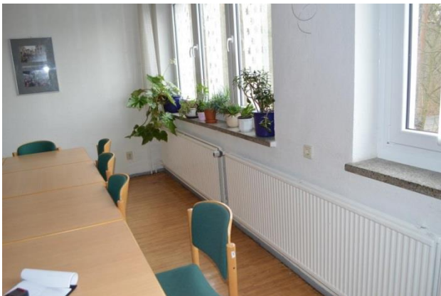
Heizkörper im Merzweckraum
