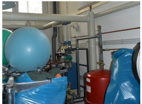
Unvollständig gedämmte Verteilungen
