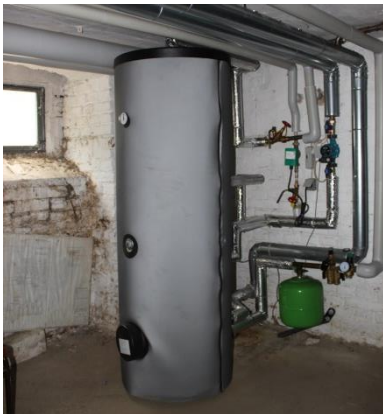
Warmwasserspeicher im Untergeschoss
