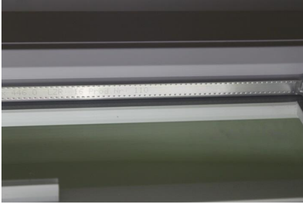
Kunststofffenster aus 2008 mit Wärmeschutzverglasung
