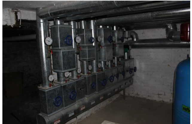
Heizungsverteilung im Untergeschoss
