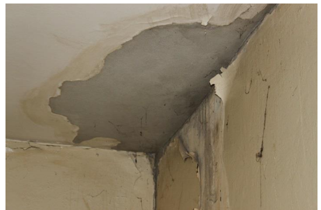
Feuchtigkeitsschäden – Dachbereich Treppenhaus
