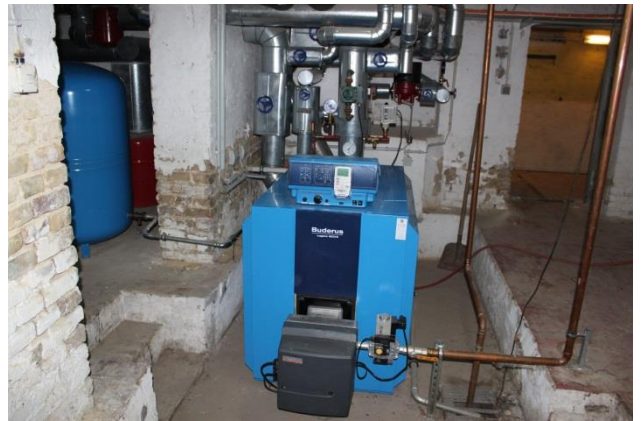
Erdgasheizung im Untergeschoss
