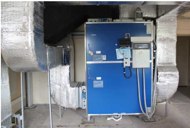
Lüftungsanlage im 3. Obergeschoss aus 2008
