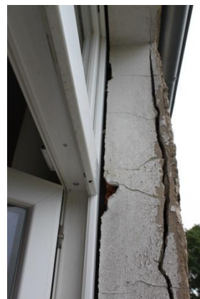
Außenputzschäden und Risse
