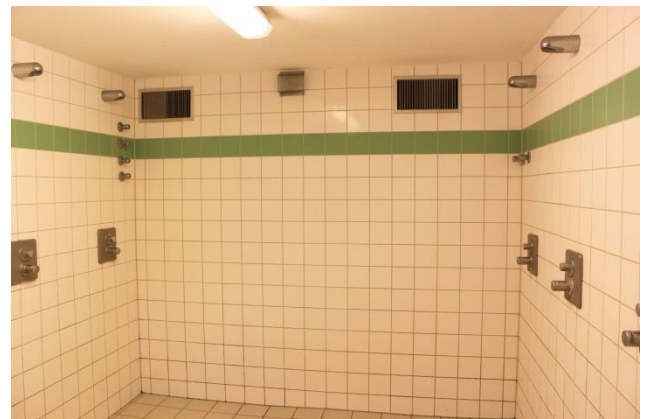
Zuluft Öffnungen - Duschaum
