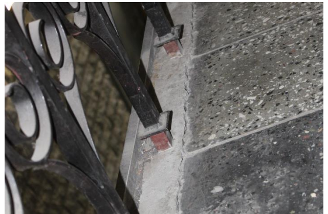
Rissbildung und Bewegung im Deckenanschluss Treppengeländer
