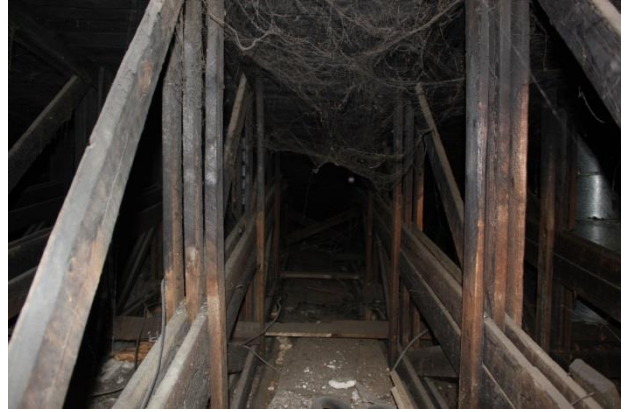
Ursprüngliches Holzdach - Brandschäden von 1978
