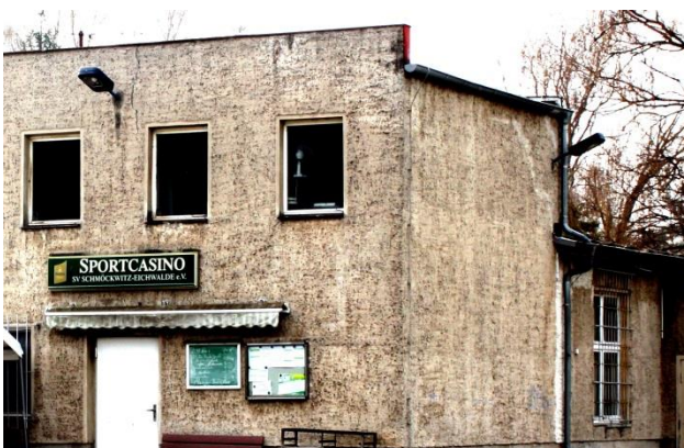
Gravierende Rissbildung – Absenkung der Gebäudeecke
