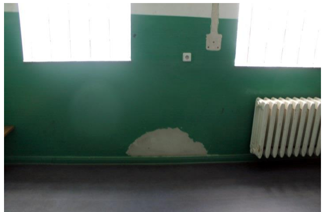
Innenputzschäden - Feuchtigkeit Außenwand
