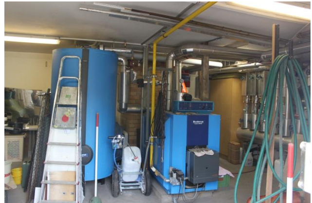
Erdgasheizungsanlage und Warmwasserspeicher
