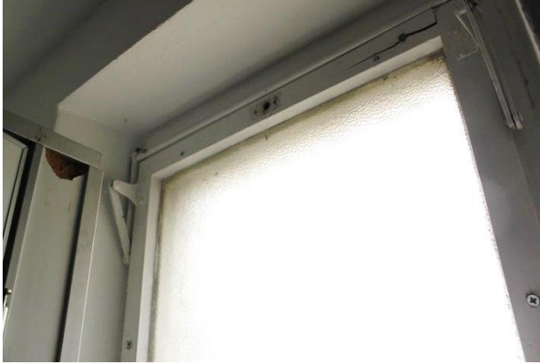
provisorischer Einbruchschutz - Fenster verschraubt
