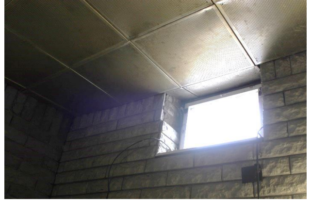
Zustand Treppenhauswand / -decke im 1.OG – z.T. wegen unterdimensionierter Küchenabluft im EG.
