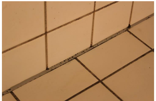
Duschaum - Schimmelbildung trotz Lüftungsanlage
