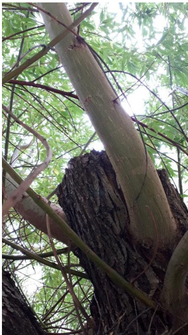
links: Detail Krone Austriebe aus der einfaulenden Kappungsstelle
