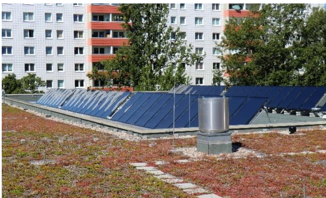
Foto 2: Solarthermieanlage auf der Nils-Holgersson-Schule, Otto-Marquardt-Str. 14
