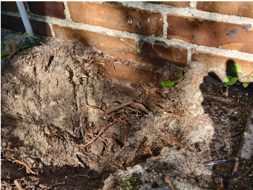
Schurf S2 / Das Mauerwerk besitzt keine Vertikalabdichtung.
