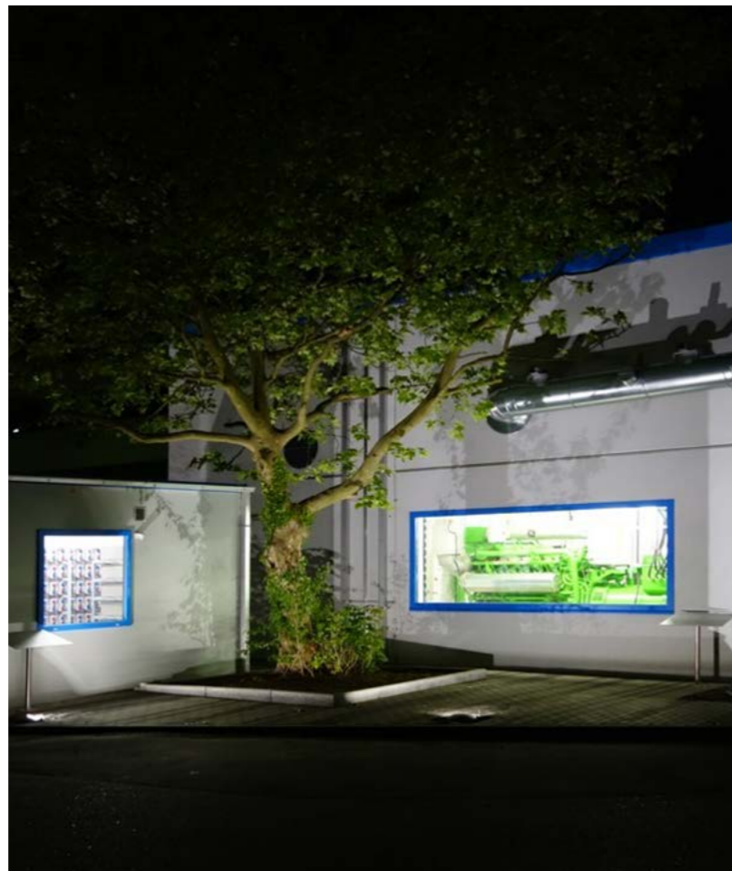
Ein 400 kW BHKW und eine 200 kWh Batterieanlage bei GE Power Conversion in Lichterfelde, Quelle: Kofler Energies GmbH
