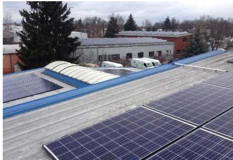
Photovoltaik-Anlage bei der Märkischen Kiste, Quelle: Kofler Energies GmbH
